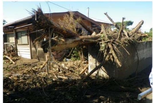
流木による家屋被害（東京都大島町）
